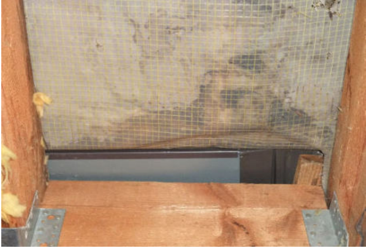
Rechter Zwischensparrenbereich oberhalb des Fensters. Dunkle Stellen sind feucht. An der Ausbeulung liegt ein Stück Holz (keine Ahnung wie das da hingekommen ist...)
