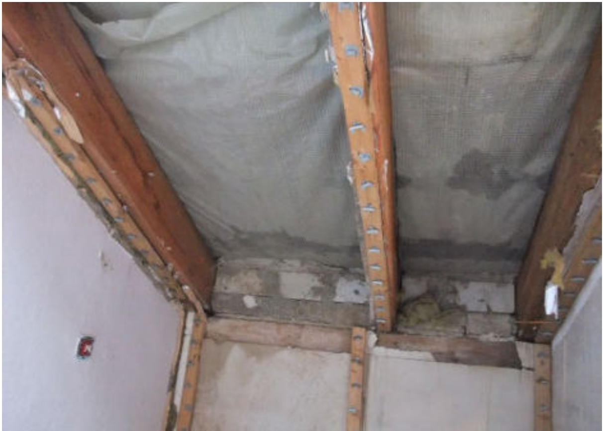
Unterhalb des Fensters. Feuchtigkeit gut zu sehen In der nächsten Detailaufnahme sieht man den rechten Zwischensparrenbereich
