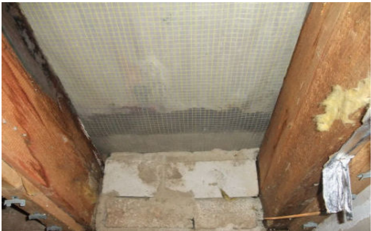
links oben gut zu sehen: Schimmel. Hier ist der Balken richtig nass. An dem dunklen Streifen spürt man beim Gegendrücken die Ziegel direkt auf der Folie. Folie spannt am Ziegel.
