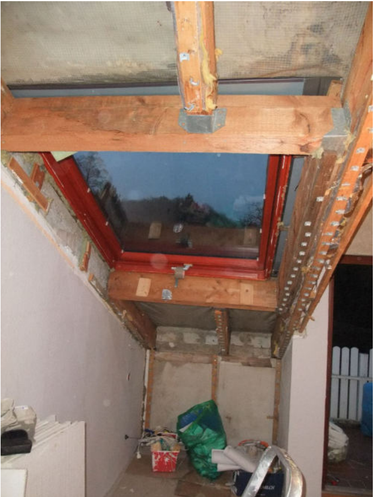
Ansicht Fenster gesamt mit Feuchtigkeit oberhalb des Fensters gut sichtbar. Die Feuchtigkeit unten sieht man hier nicht so gut
