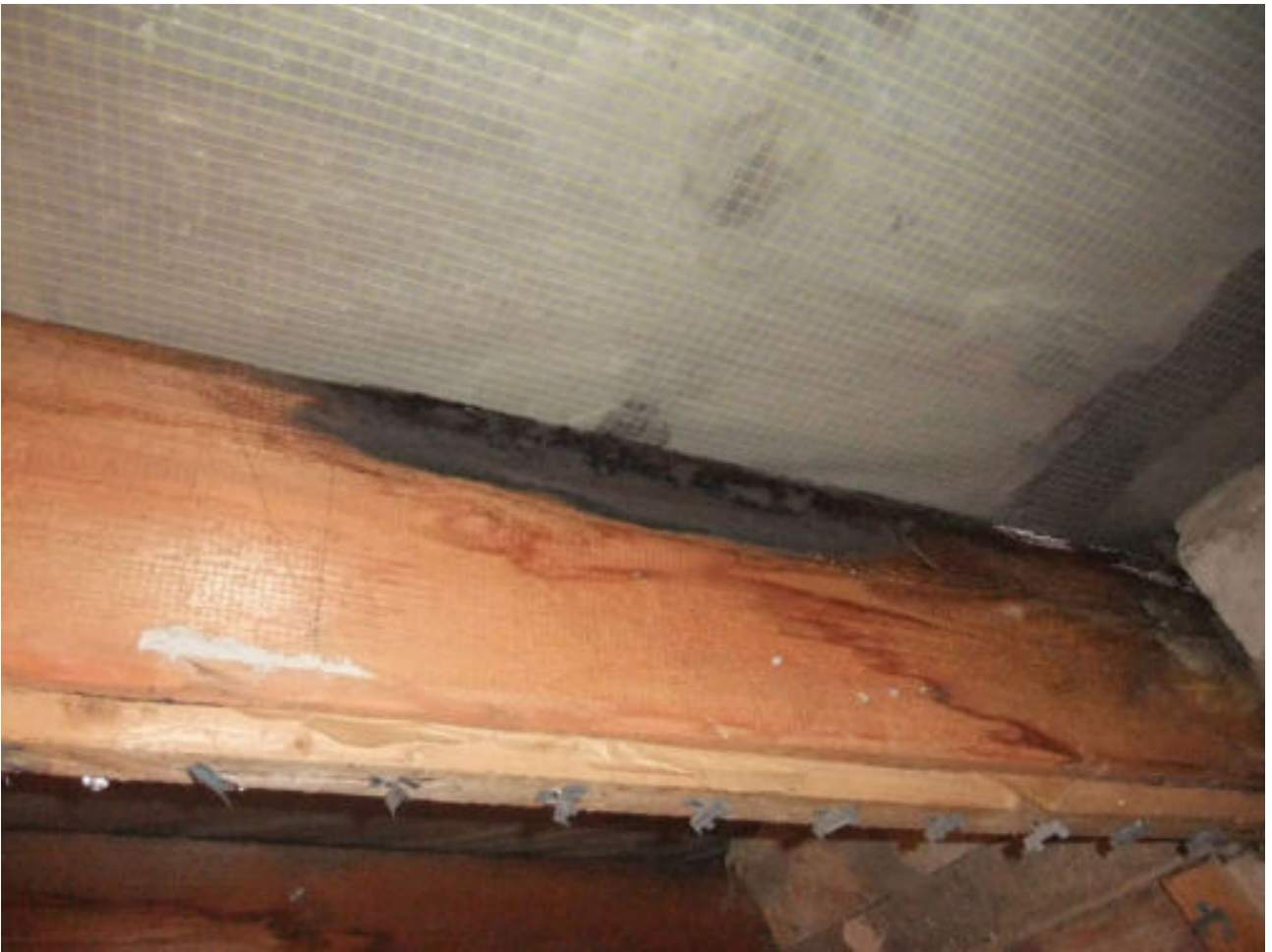
Im Detail vom vorherigen Bild: Schimmel. Insgesamt etwa 30cm langer Bereich.
