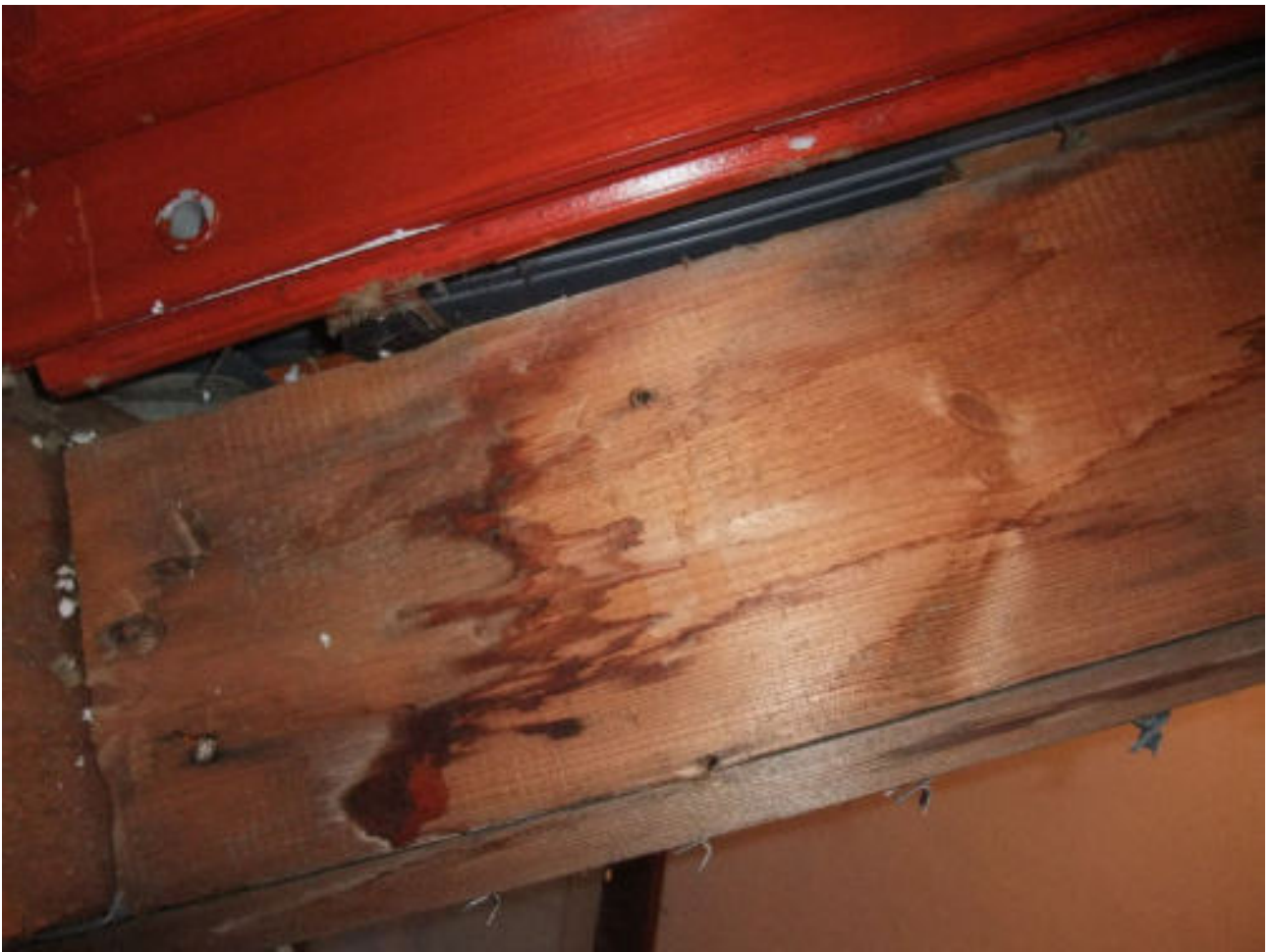
Balken rechts am Fenster. Hier war der Balken mal nass, fühlt sich aber nun trocken an.
